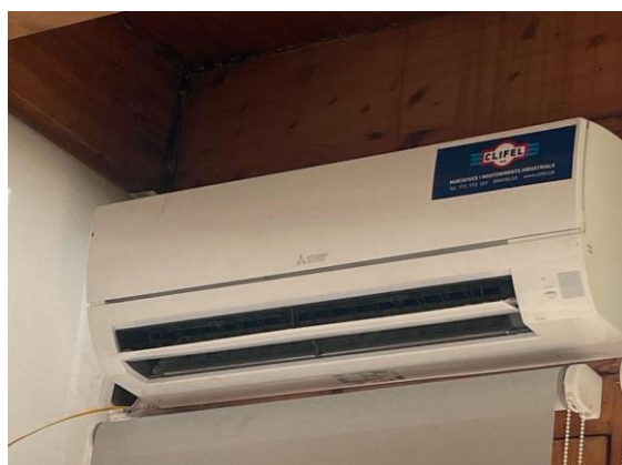
写真 16 FinishTower 内に三菱電機製の空調装置
