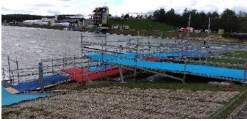
(写真) 車椅子専用 Pontoon
