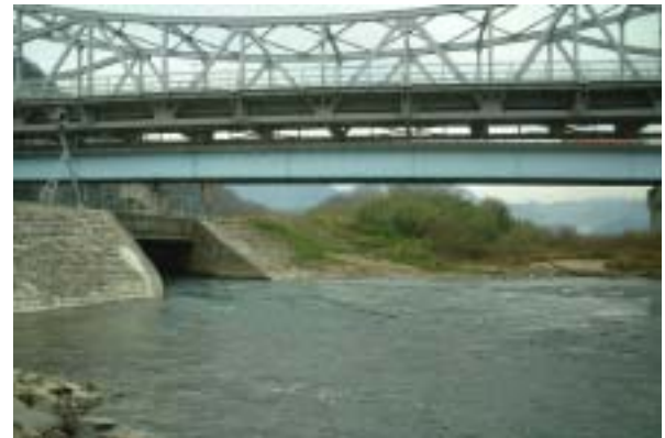
放水口からの強い流れにも注意が必要。
