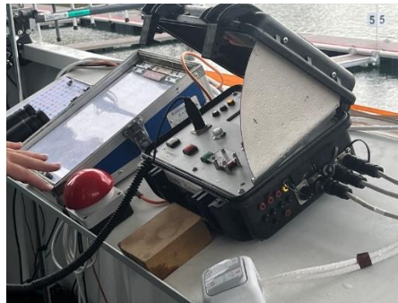
スターター操作盤
